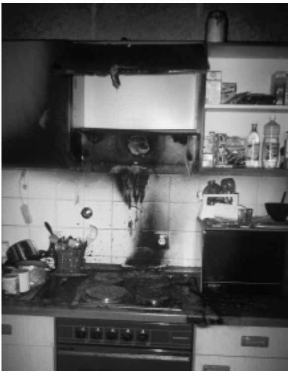
Zündquelle Elektroherd in einer Wohnküche
